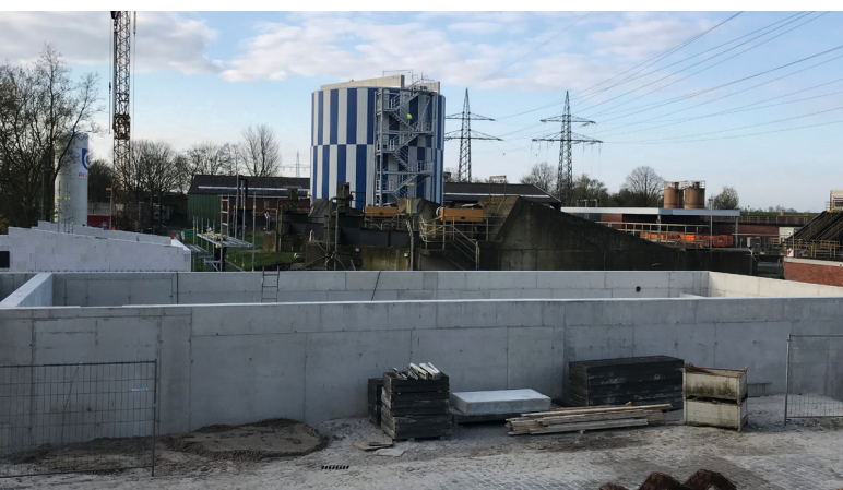
Faulturm mit Vorklärung
