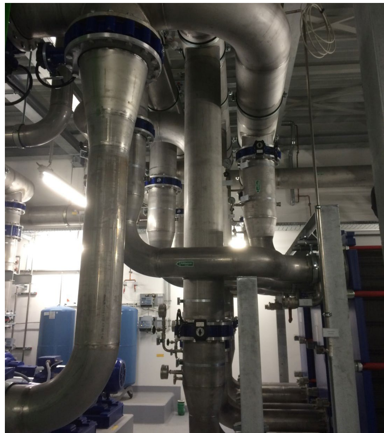
Kühlwasser-Zentrale in Edelstahl für ein Hochleistungs-Rechenzentrum
