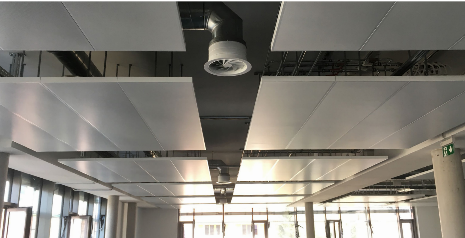
Heiz-Kühlsegel-System schallabsorbierend in einem Bürogebäude, Sichtinstallation
