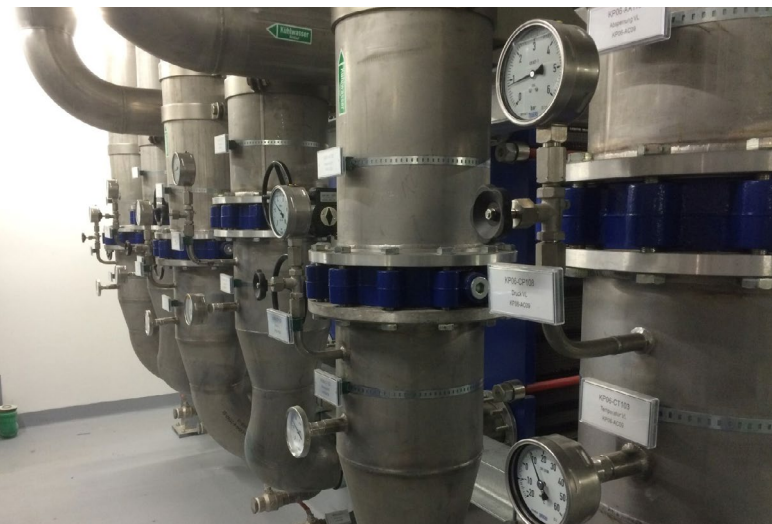
Kühlwasser-Zentrale in Edelstahl für ein Hochleistungs-Rechenzentrum
