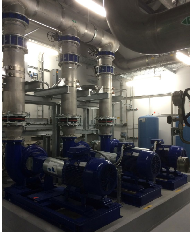
Kühlwasser-Pumpenzentrale in Edelstahl für ein Hochleistungs-Rechenzentrum
