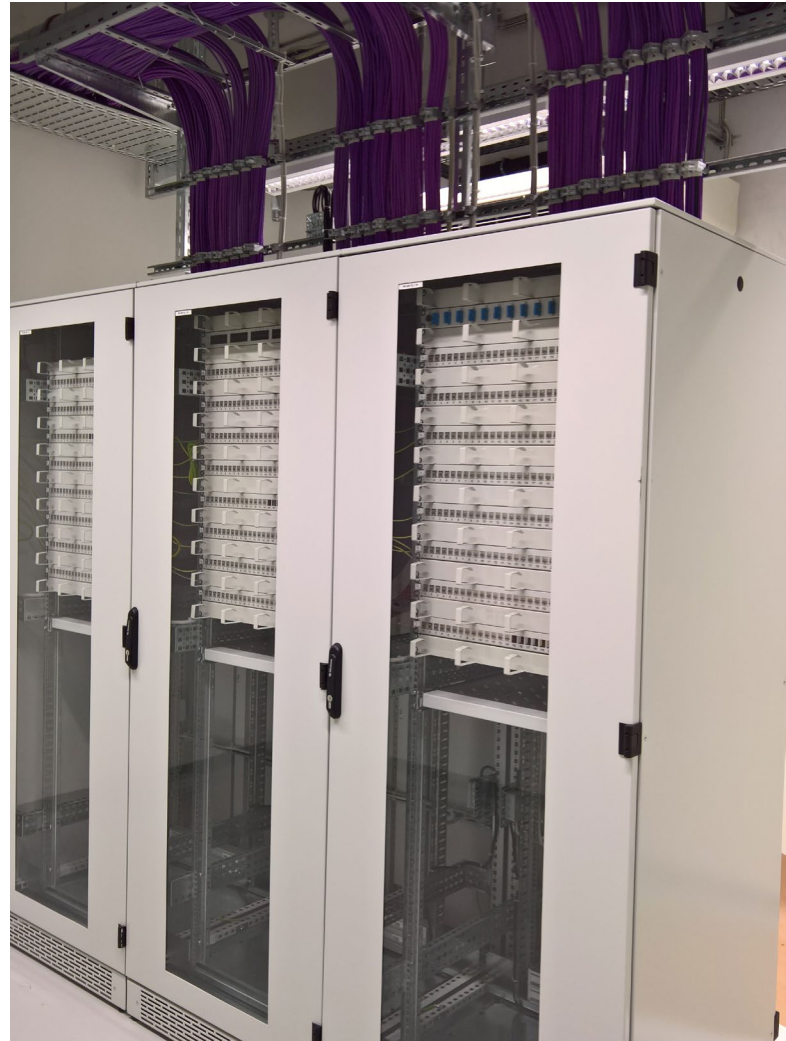
Serverraum mit Kabelführung
