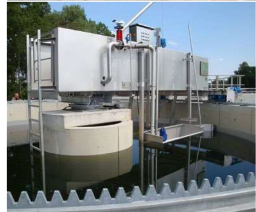
Kläranlage in Schwepnitz: Ausrüstung für das Nachklärbecken.
